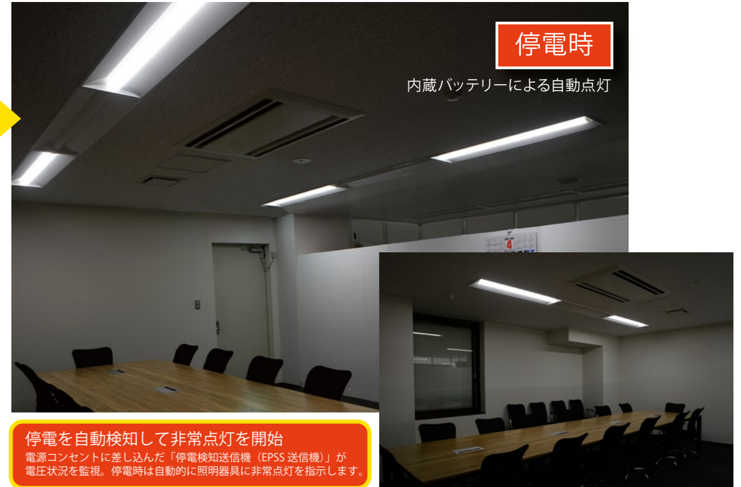
■ 会議室 - 防災用Nuシリーズ(停電時)
