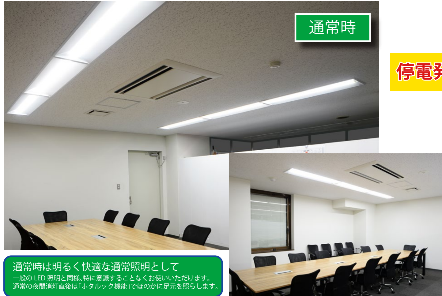
■ 会議室 - 防災用Nuシリーズ(通常点灯時)
