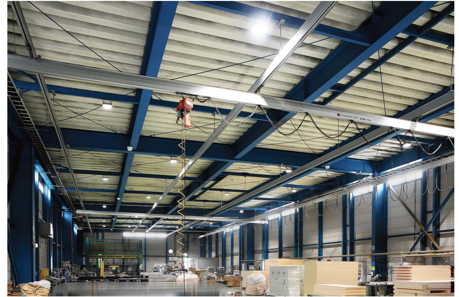
■ 工場 - 高天井用 LED照明器具
