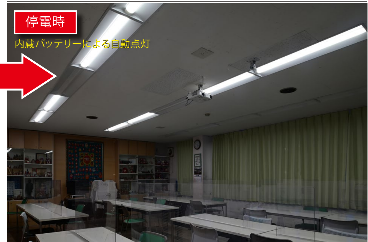
■ 食堂 LED一体型ベース照明 防災用Nuシリーズ(非常点灯)
